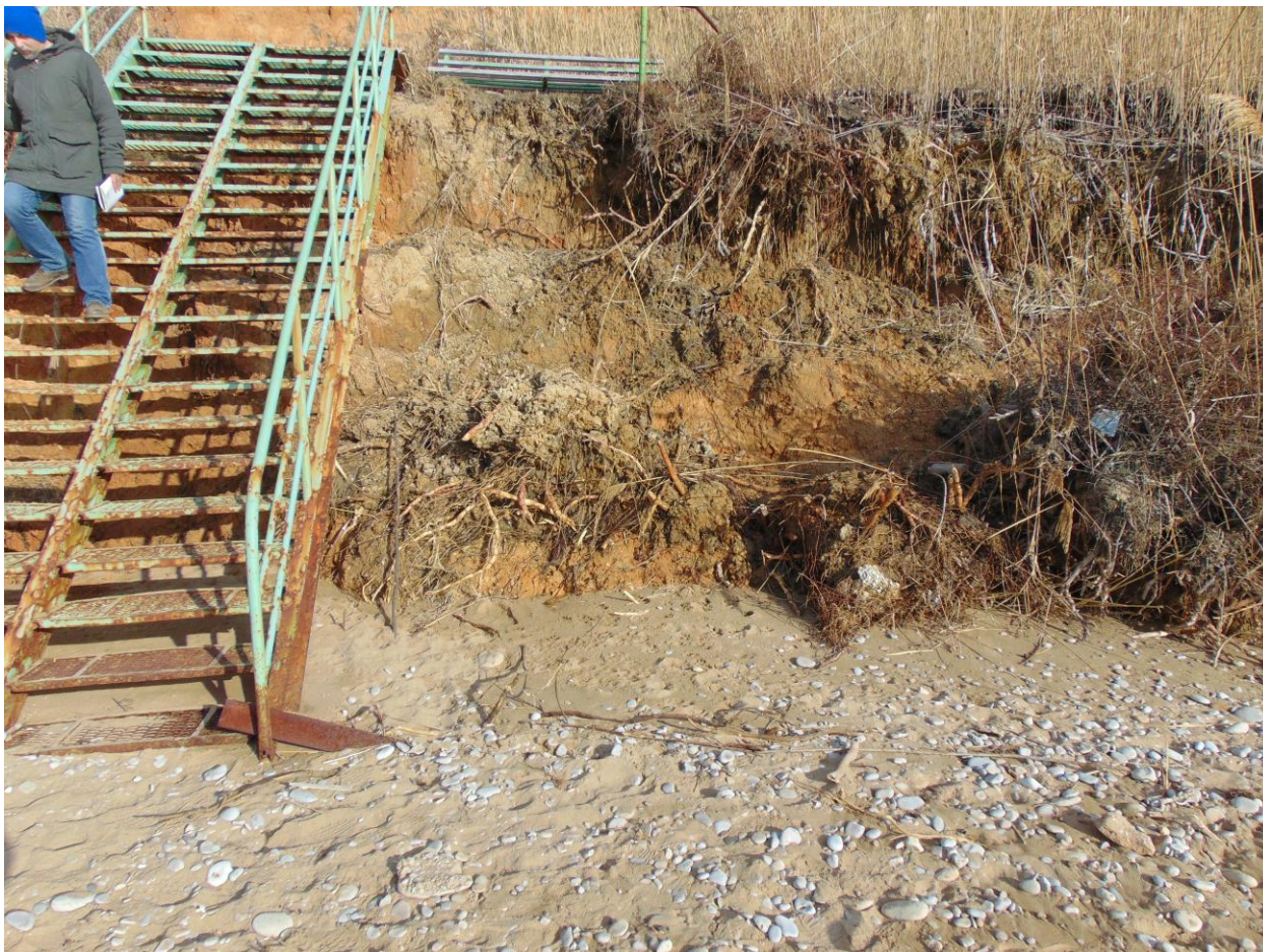
Фото № 6. Левый борт оползня «Балочный» № 915. Правый борт. (67-1110-0005). В основании абразионного уступа свежие оплывины, высачивание воды
