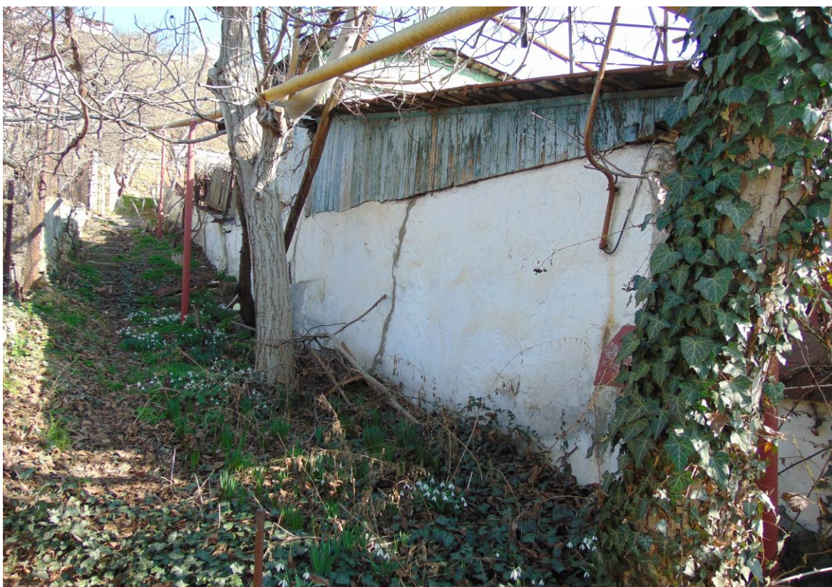
Фото № 15. Оползень «Подольцевский» № 1071 (67-1110-00010)
