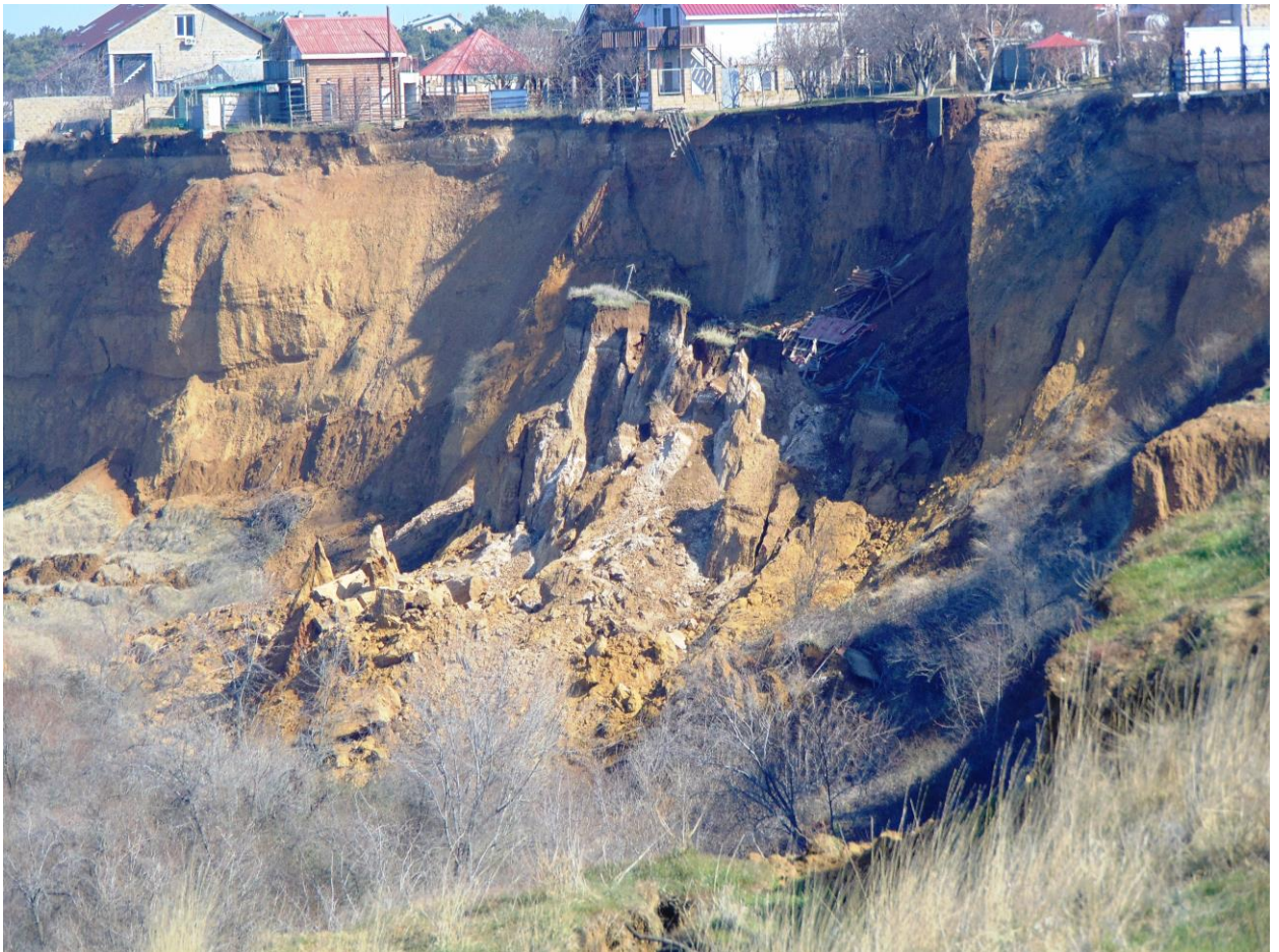
Фото № 13. Смещение блока 1-го порядка 07.03.2019 г. в пределах ТСН «Парус» (67-1110-0009)
