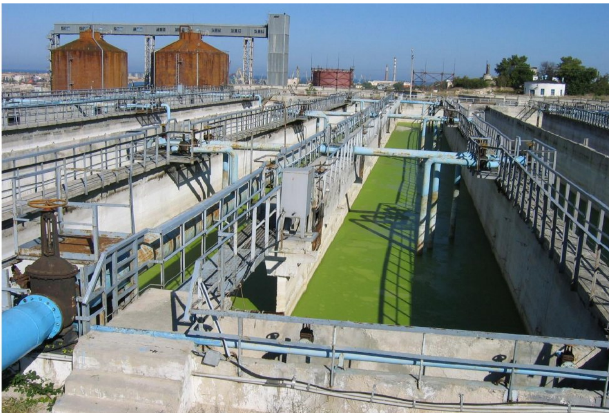
Рис. 1.4. Очистные сооружения ГУП города Севастополя «Водоканал»
