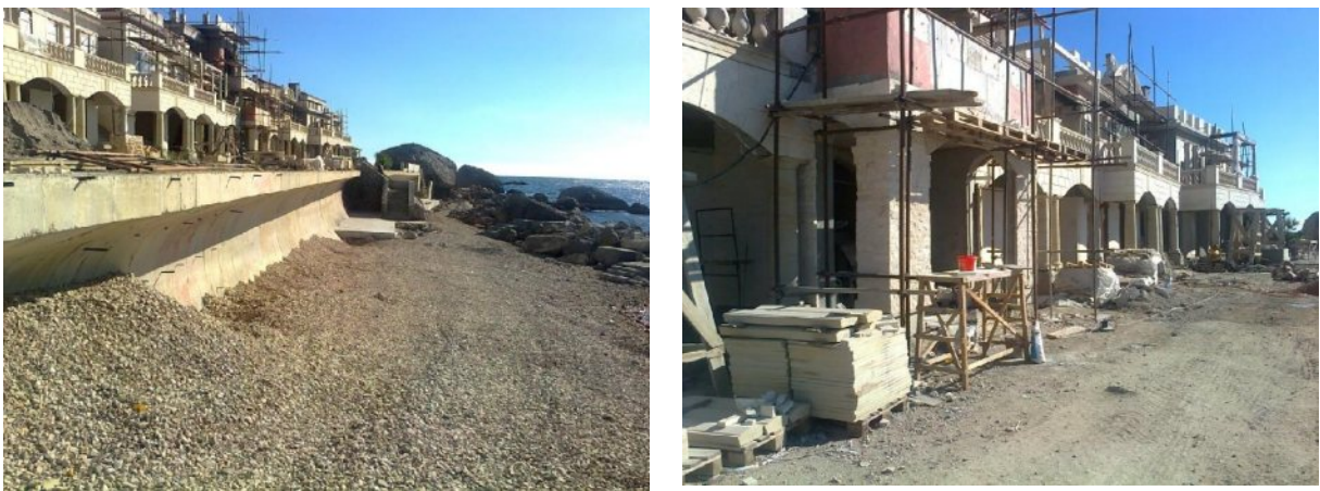
Рис. 9.5. В ходе строительства практически уничтожена территория и акватория Памятника природы «Прибрежный аквальный комплекс около мыса Сарыч» общей площадью 0,7983 га.
