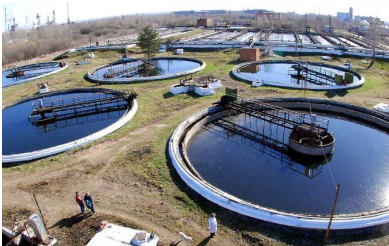
Рис. 1.3. Очистные сооружения ГУП города Севастополя «Водоканал»
