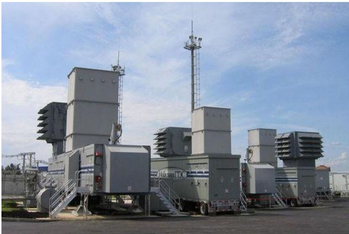
Рис. 1.6. Мобильные газотурбинные станции обособленного подразделения «Севастополь» ОАО «Мобильные ГТЭС»
