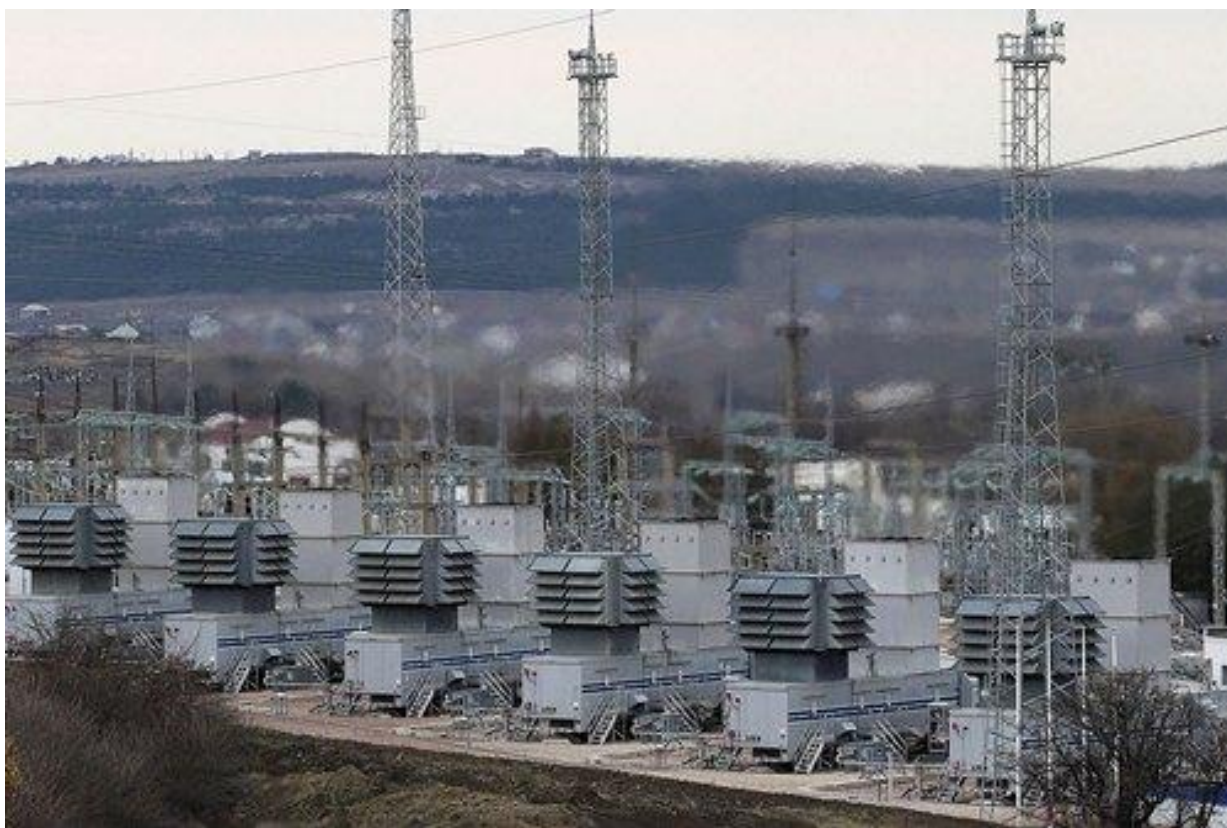
Рис. 1.5. Мобильные газотурбинные станции обособленного подразделения «Севастополь» ОАО «Мобильные ГТЭС»
